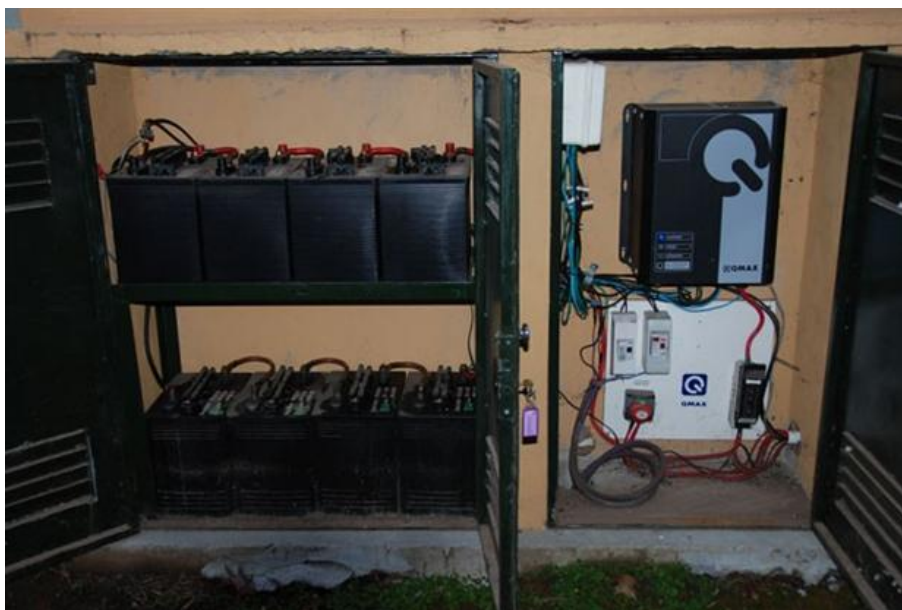
El banco de baterías e inversor - Foto: sustentator.org
