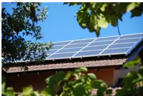
Vista del techo con paneles solares - Foto: sustentator.org
