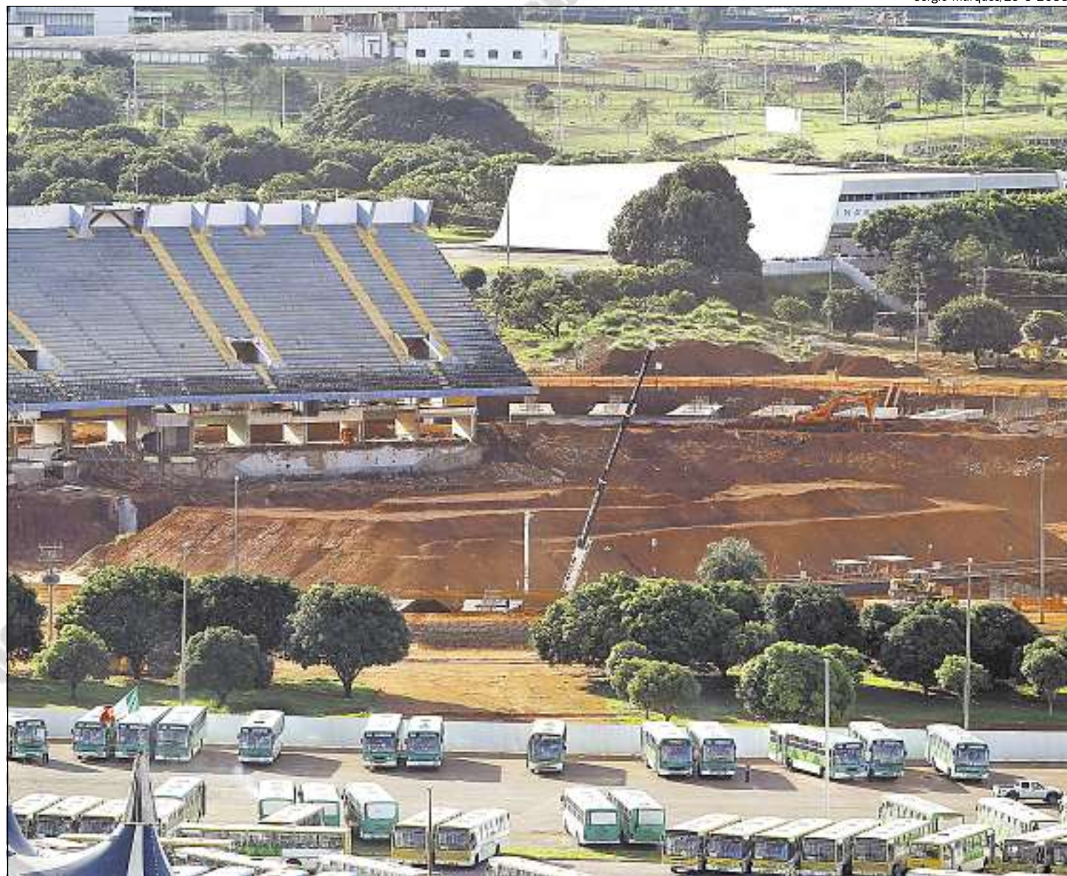
AS OBRAS de construção do novo estádio: a arquibancada do antigo Mané Garrincha continua de pé como parte do projeto, mas será implodida
